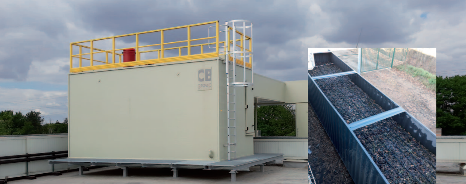
foto boven: luchtwasser aan de stallen foto rechts: biofilter
